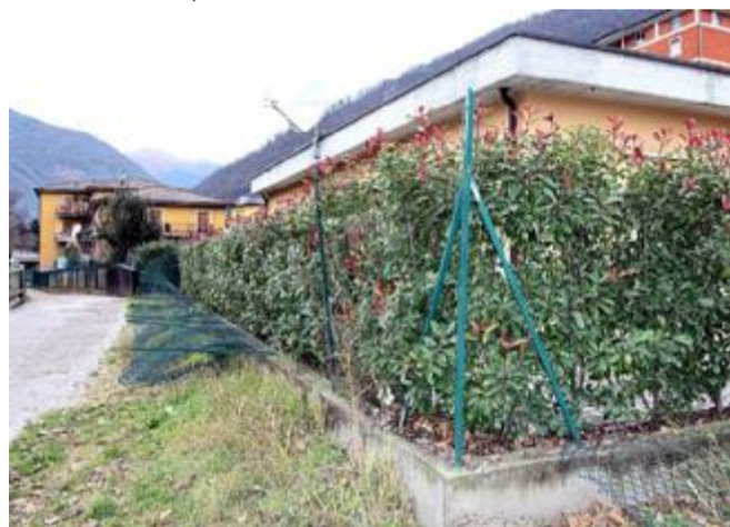
La recinzione divelta all'esterno della centralina
